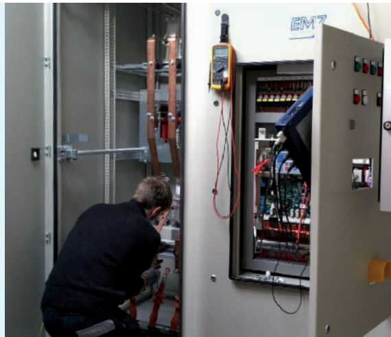
Inbetriebnahme 6.000 V Softstarter.
