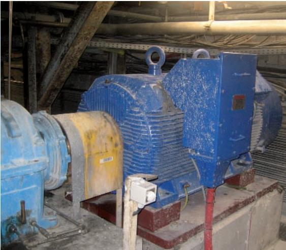
550 kW Käfigläufermotor AKR 355-04 als Antrieb eines Vakuumbelüfters in einer Papierfabrik.
